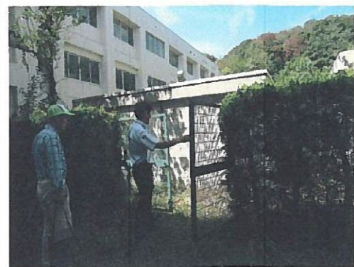
地上受水槽入口
